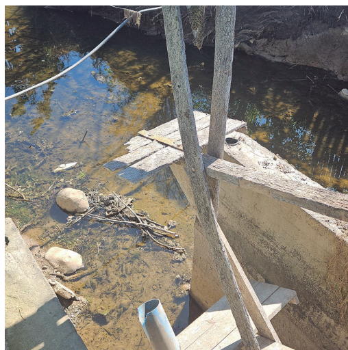
Paleta con daño mayor y sin capacho.
