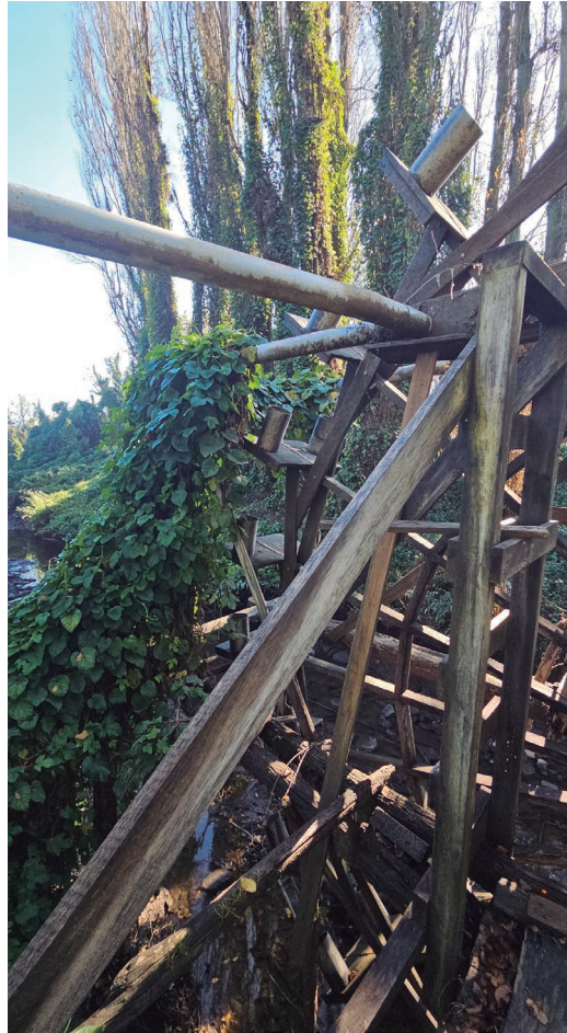
Vista de conexión de tubería y canoa.
