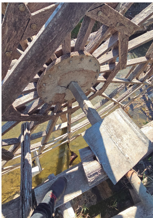
Eje con protección (cubierto por una lámina metálica).
